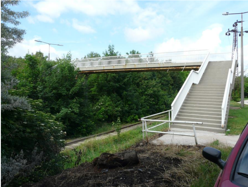
3. kép: A 6-os számú vasútvonal feletti gyalogos felüljáró az Adonyi útnál, kerékpáros vezetősín nélkül (Fotó: Papp Márton)
