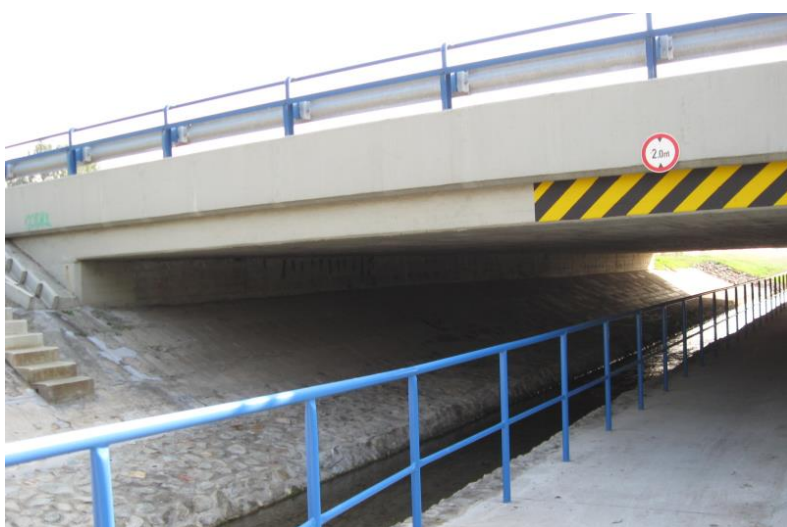
6. kép: Császár-víz töltésén vezető kerékpárút átvezetése az M7 autópálya alatt (fotó: Juhászné Viniczai Ágnes)
